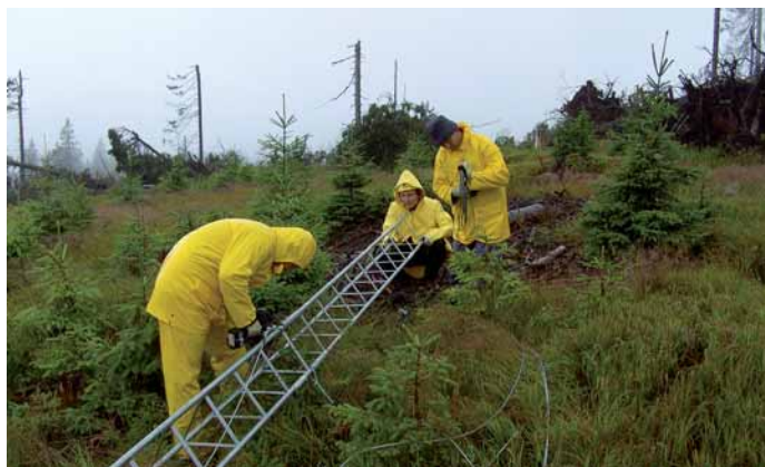
Mastenmontage für die Aufnahme meteorologischer Messinstrumente (Foto: Heiner Rall)
