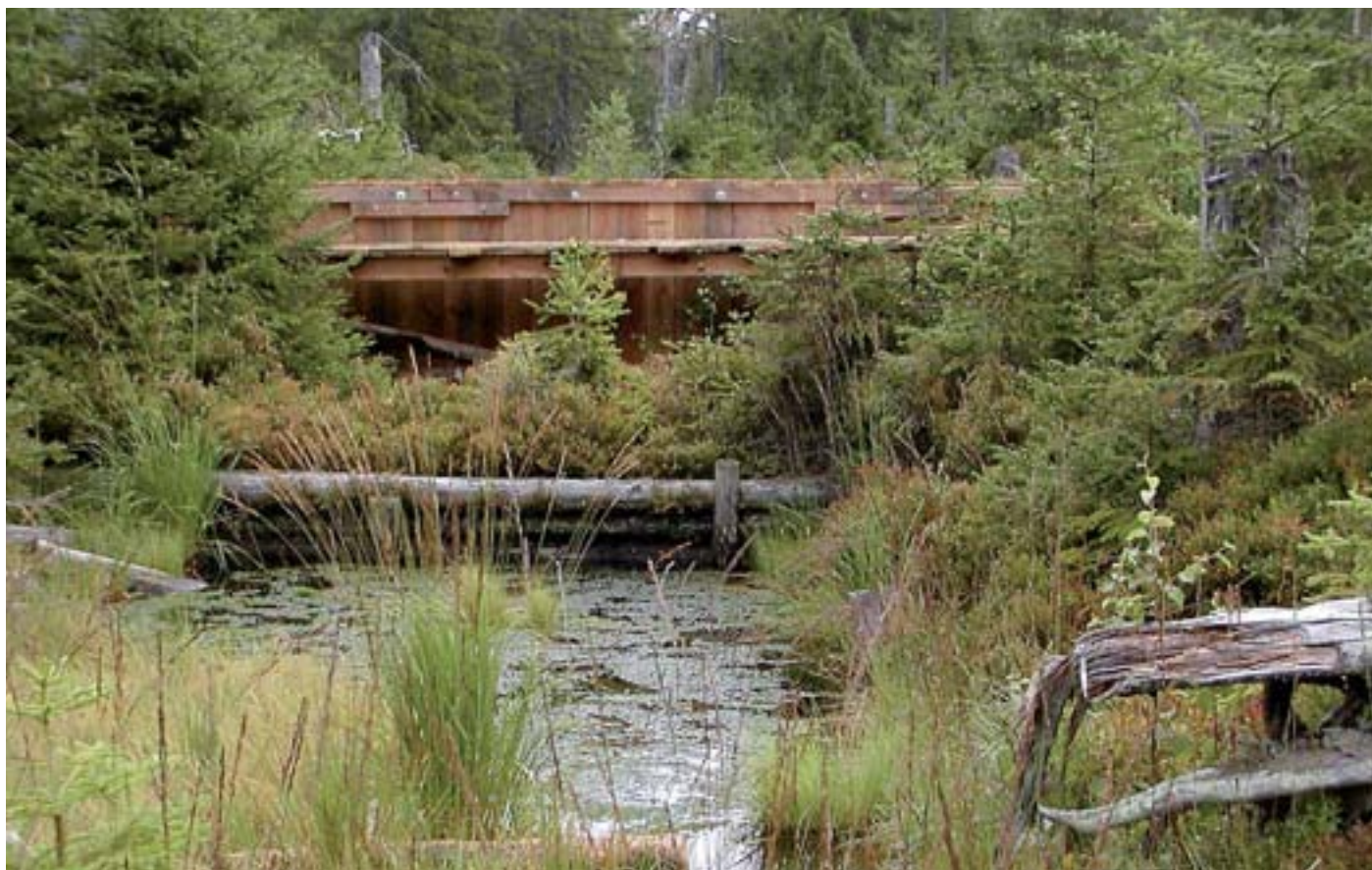
Durch Spundwände, die bis an die Hochmooroberfläche reichen, werden die früher mit schlecht abdichtenden Methoden verbauten Entwässerungsgräben effektiver angestaut (Foto: Karl-Heinz Englmaier)
