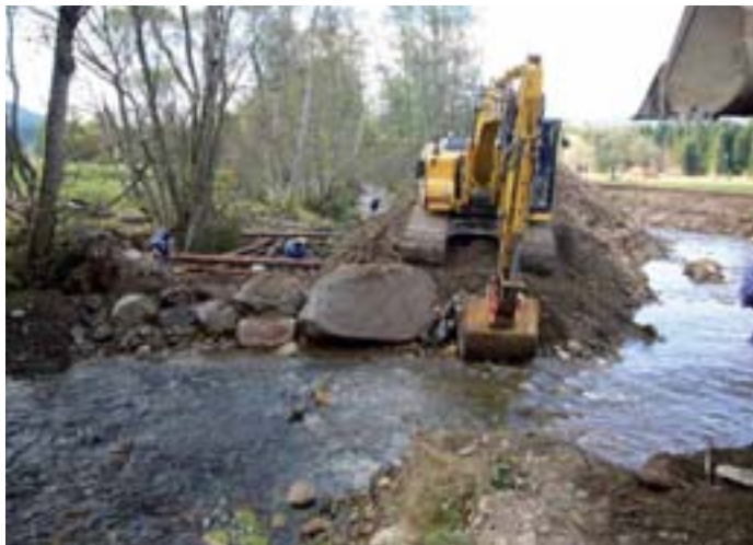
Wiederherstellung früherer Mäanderschleifen am zur Trift begradigten Kolbersbach - mit dem Bagger in wenigen Stunden erledigt (Foto: Ingo Brauer)
